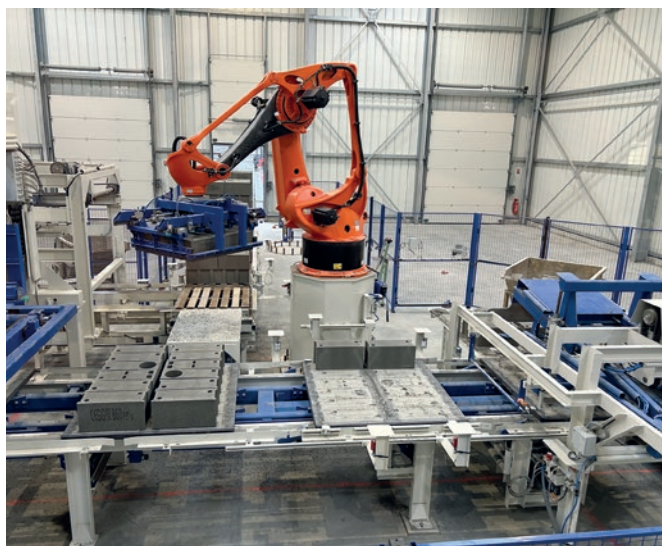
Palettisation par robot dans le circuit de transitique de la nouvelle installation Quadra Q12
