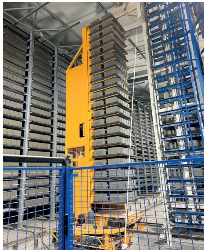
Etuves de la nouvelle Quadra Q12 avec planches Wasa Uniplast Ultra
