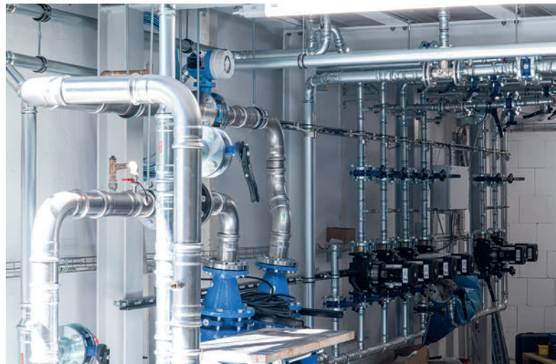
Здесь водопровод от скважины длиной 1,2 км поступает в технический цех
