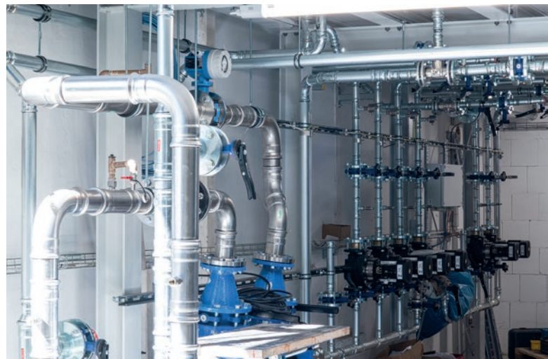
Hier kommt die insgesamt 1,2 km lange Zuleitung des Brunnens in der Technik-Halle an.
