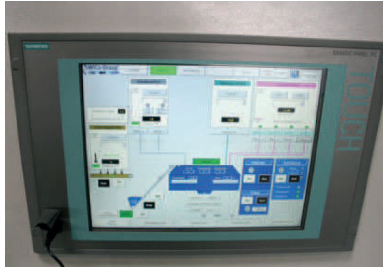
Mischprozess und Füllstände werden am Monitor visuell dargestellt.
