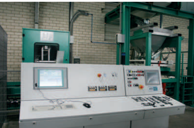
Vom Bedienpult aus kann der Mitarbeiter die komplette Fertigung überwachen.
