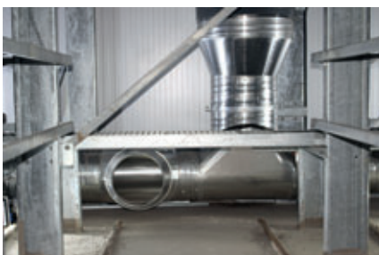
Luftauslass am Boden der Kammer. Ein effizientes Kreislaufsystem sorgt für eine gleichmäßige Umströmung mit dem exakt temperierten Luftgemisch.
