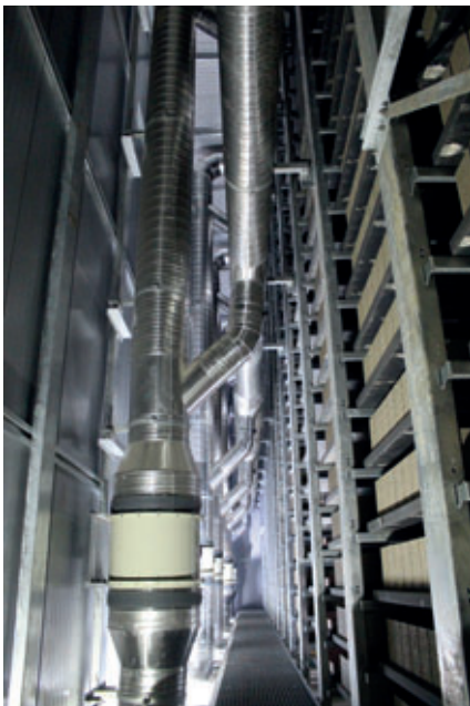
Umwälzkreise der ProCure-Anlage von Rotho
